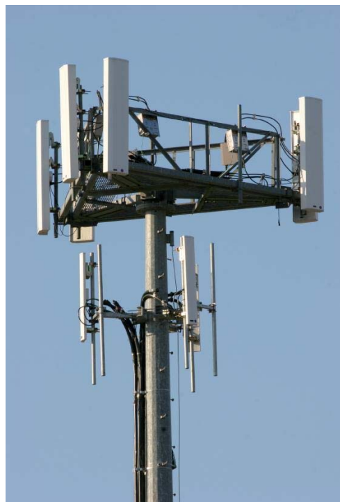
Antennes sur un support d'antennes 6
